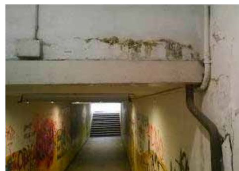
Infiltrazioni d'acqua nel sottopasso
